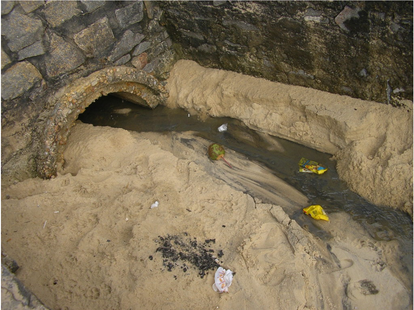
Figura 03: Ponto Extra 02 (saída de galeria pluvial, em frente ao Hotel Reis Magos, na praia dos Artistas),
