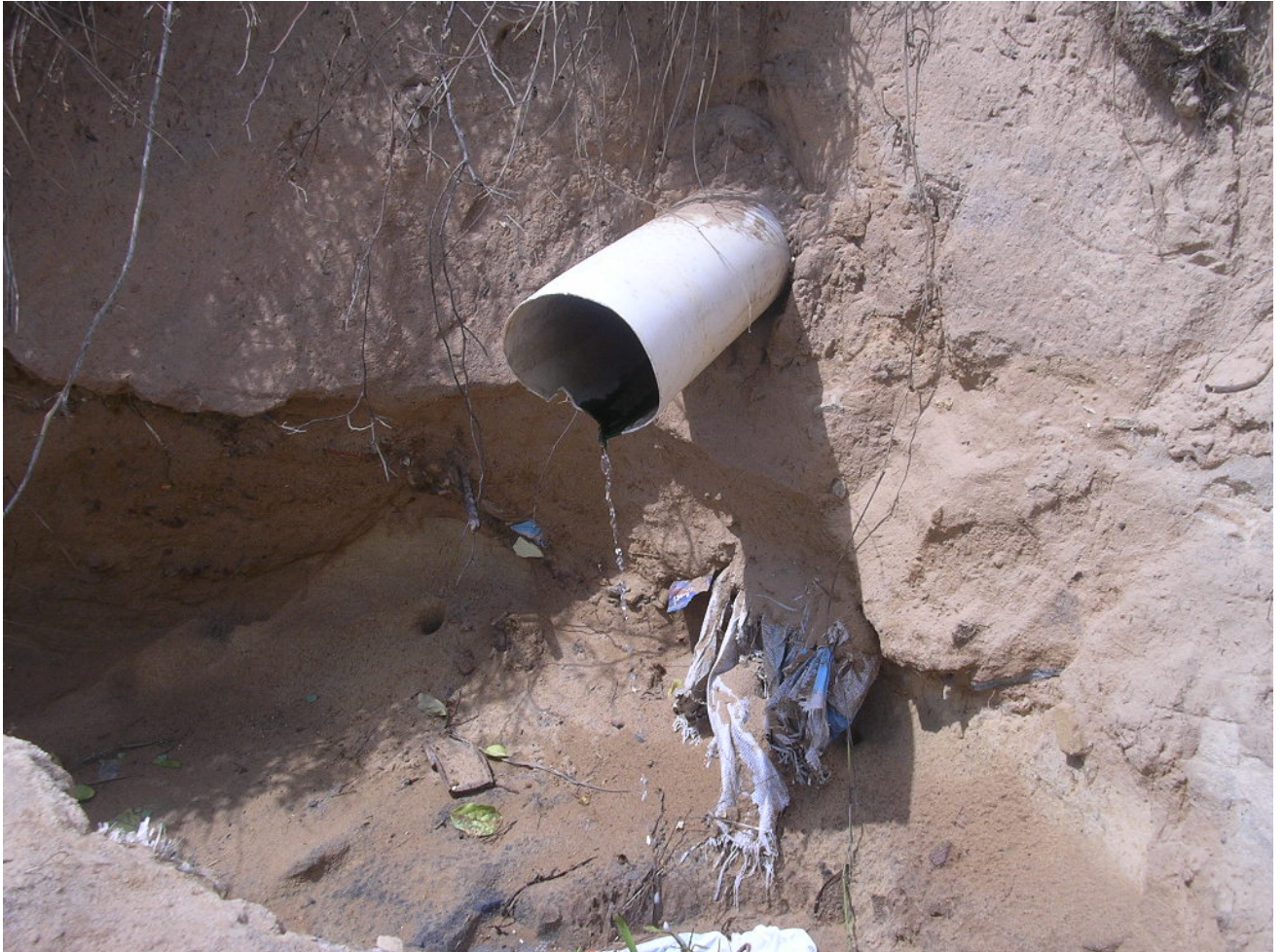
Figura 08: Ponto Extra 07 (tubulação de esgoto exposta no calçadão de Ponta Negra, em frente ao Hotel Esmeralda).
