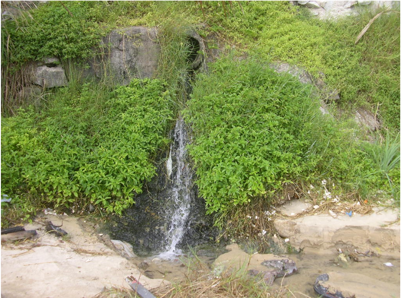
Figura 05: Ponto Extra 04 (saída de galeria pluvial, ao lado do “gabião”, na praia de Areia Preta).
