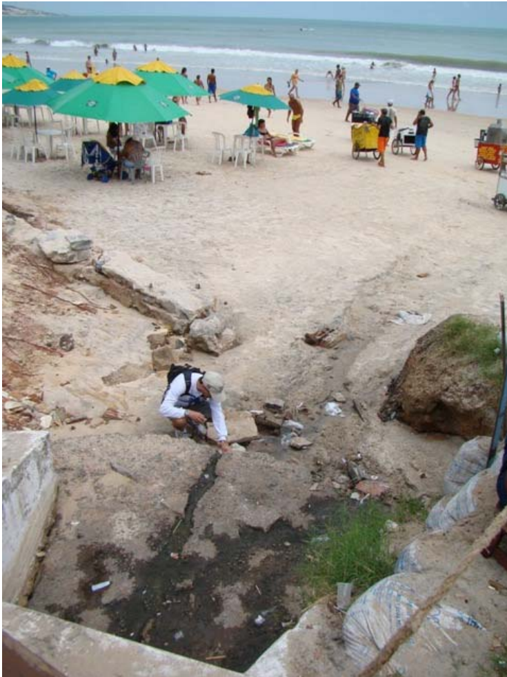
Figura 5 – Fotografia mostrando ponto de lançamento de efluentes na Praia de Ponta Negra (NT 01 - galeria pluvial posicionada junto ao calçadão), observando-se que, mesmo não havendo registro de chuvas recentes, tem-se o lançamento de efluentes na praia.
