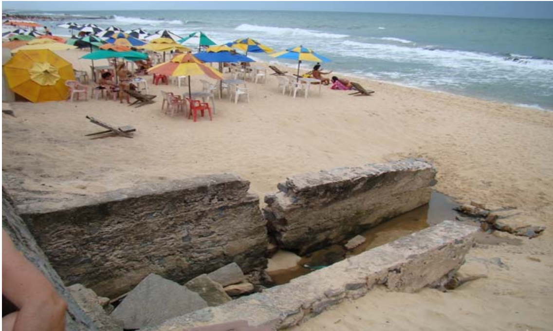
Figura 15 – Fotografia mostrando galeria pluvial posicionada junto ao calçadão na Praia do Meio com lançamento de efluentes na face praias, embora não se tenha registro de chuvas recentes nas proximidades.
