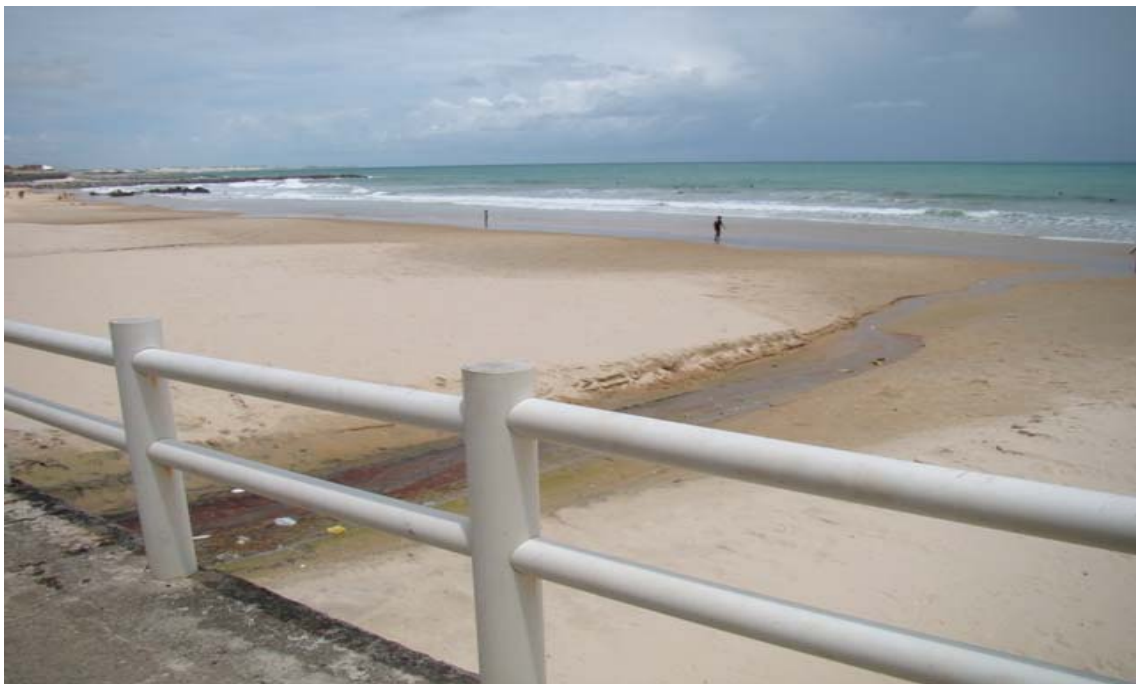
Figura 11 – Fotografia mostrando o ponto de lançamento de efluentes na Praia de Areia Preta NT 07, mesmo não havendo registro de chuvas recentes nas proximidades.
