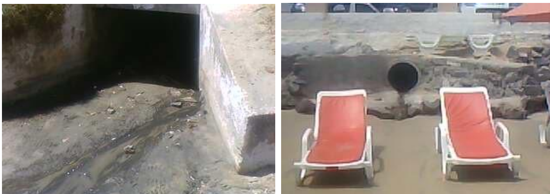
Figura 24: Efluentes saindo das redes de galerias pluvial na Praia de Ponta Negra.
