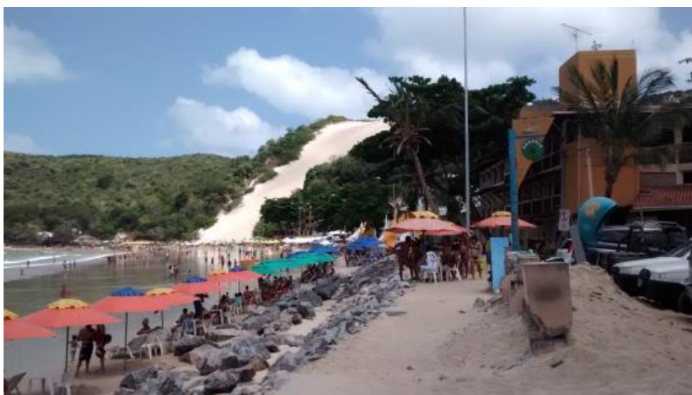
Figura 14 – Enrocamento instalado na praia de Ponta Negra visando proteger a linha de costa da erosão costeira.
