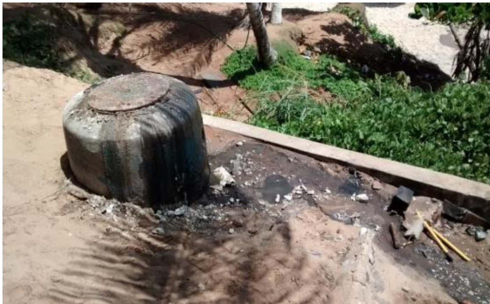
Figura 23 – Fotografia registrando poço de visita da CAERN jorrando esgoto na praia de Ponta Negra.
