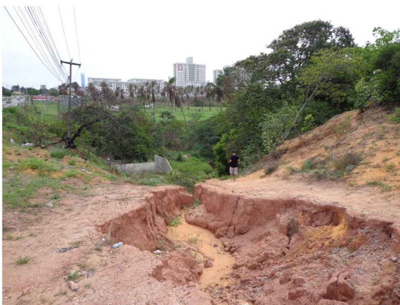
Figura 33. Aumento progressivo de uma “voçoroca”, formada nas proximidades da PI-12, após as obras de construção do túnel.
